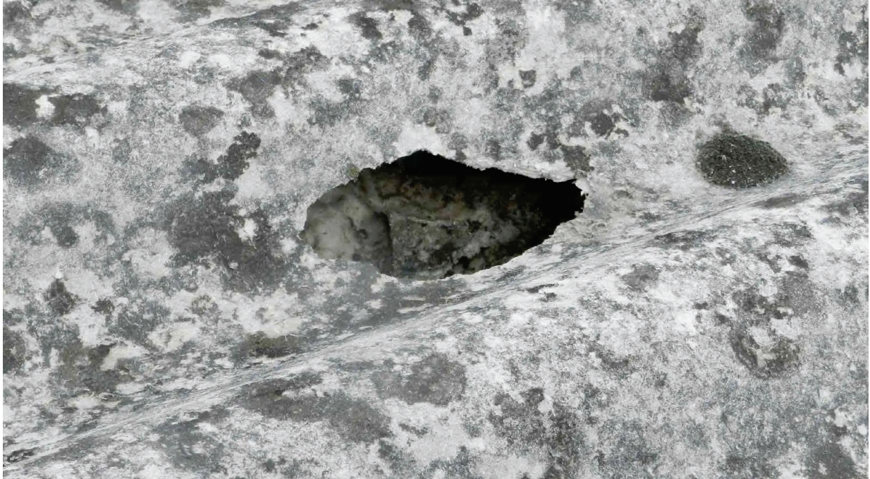
Effetto di rottura di una lastra in fibrocemento per effetto della grandine
