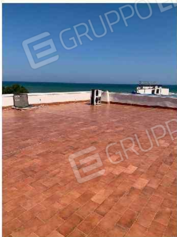
Foto 5-6: Comune di Vico del Gargano (FG) – Località San Menaio Terrazzo del fabbricato in Via Pineta Marzini n. 42
