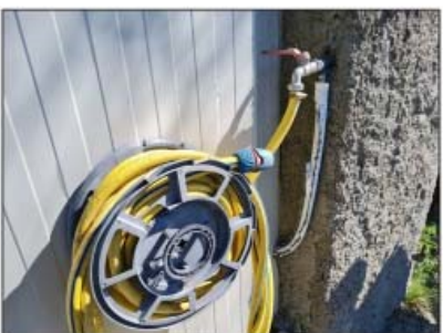
FOTO 95 - LOTTO D Punto acqua esterno
