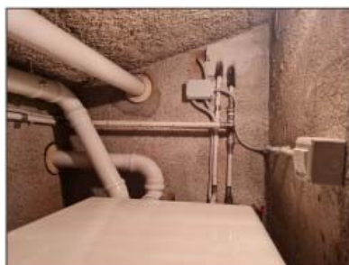
FOTO 38 - LOTTO C Caldaia riscaldamento e ACS
