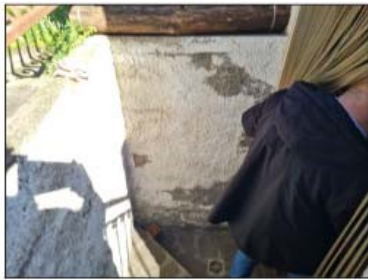
FOTO 58 - LOTTO B e C Umidità scala cantina
