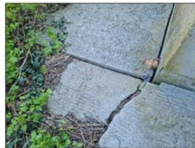
FOTO 99 - LOTTO D Deposito assestamento marciapiede
