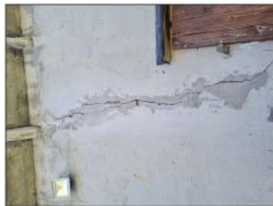
FOTO 98 - LOTTO D Crepe e fessurazioni deposito esterno
