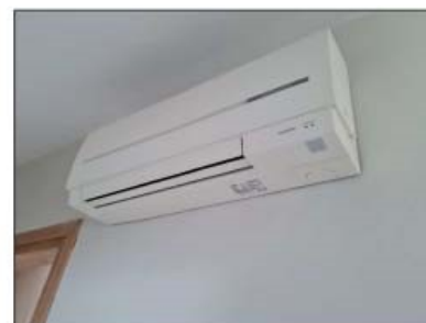
FOTO 39 - LOTTO C Condizionatore raffrescamento
