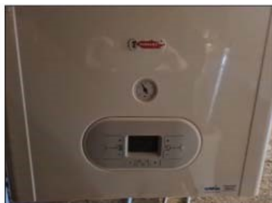
FOTO 61 - LOTTO B Caldaia riscaldamento e ACS
