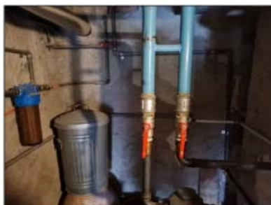
FOTO 62 - LOTTO B Impianti centrale termica
