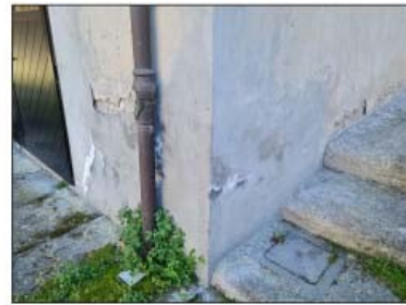
FOTO 60 - LOTTO B e C Umidità da risalita muri esterni
