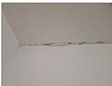
FOTO 119 - LOTTO D Crepe e fessurazioni interne abitazione
