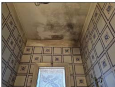
FOTO 55 - LOTTO B Soffitto bagno muffa e infiltrazioni
