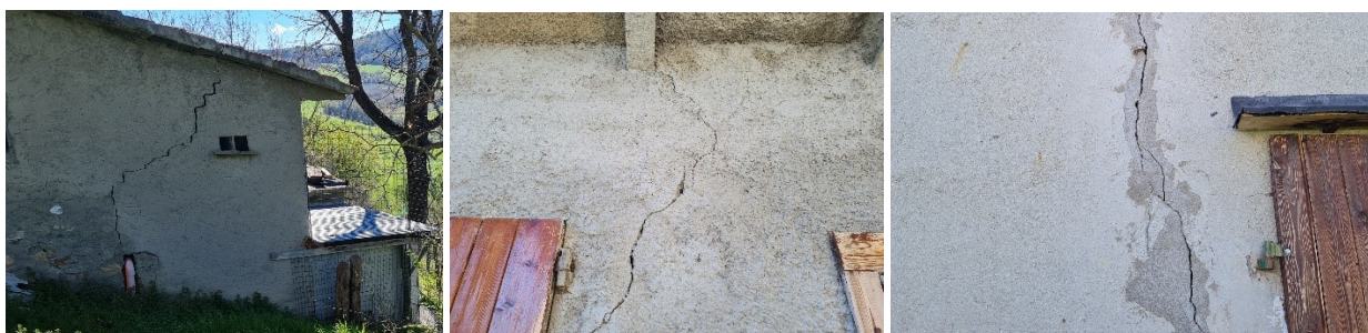
ASSESTAMENTI STRUTTURALI SUI SERVIZI STACCATI
