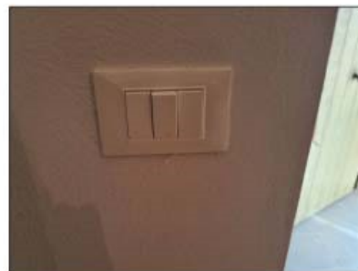
FOTO 114 - LOTTO D Impianto elettrico
