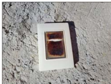
FOTO 89 - LOTTO D Interruttore esterno
