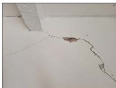
FOTO 118 - LOTTO D Crepe e fessurazioni interne abitazione
