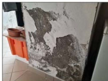
FOTO 56 - LOTTO B Infiltrazioni e umidità da risalita
