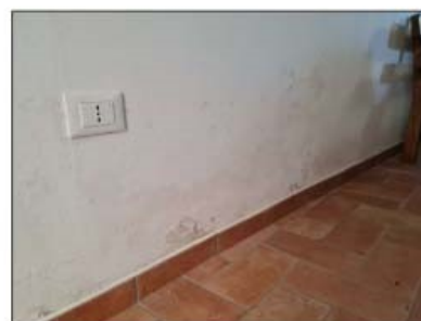
FOTO 120 - LOTTO D Umidità di risalita nei muri
