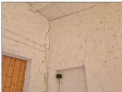
FOTO 97 - LOTTO D Crepe e fessurazioni deposito esterno
