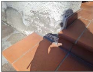
FOTO 59 - LOTTO B e C Umidità da risalita muri esterni
