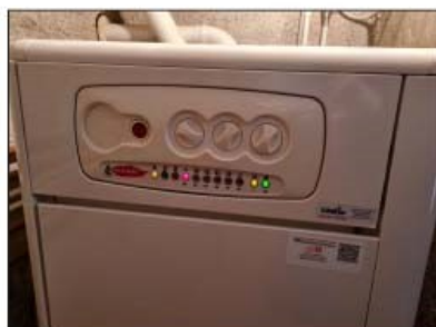
FOTO 37 - LOTTO C Caldaia riscaldamento e ACS
