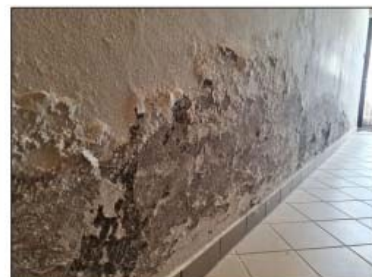
FOTO 57 - LOTTO B Infiltrazioni e umidità da risalita
