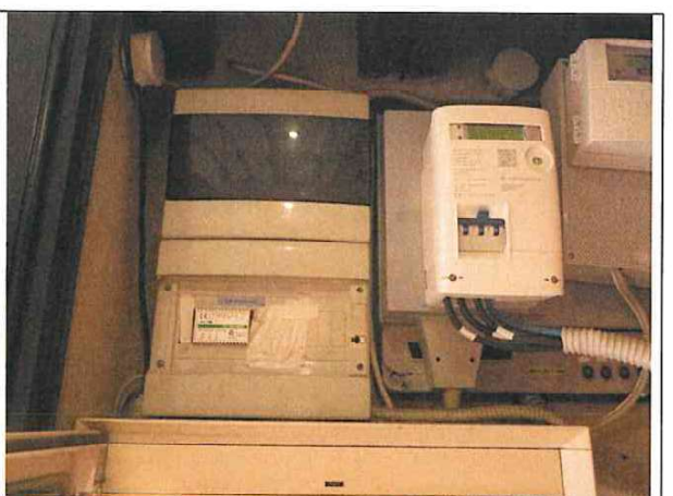
Foto n°82: contatori del ristorante
