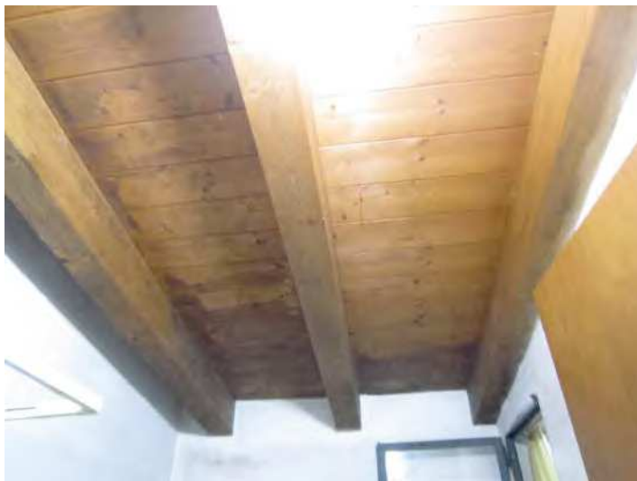
VISTA MACCHIE SUI TRAVETTI E SULL'ASSITO IN LEGNO NEL BAGNO
