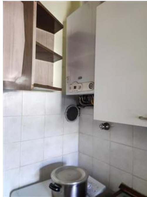
Particolare caldaia murale
