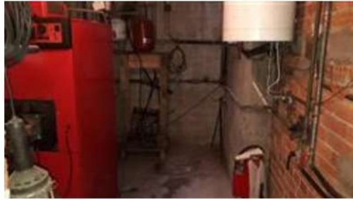
CENTRALE TERMICA NEL LOCALE COMUNE A TERZI
