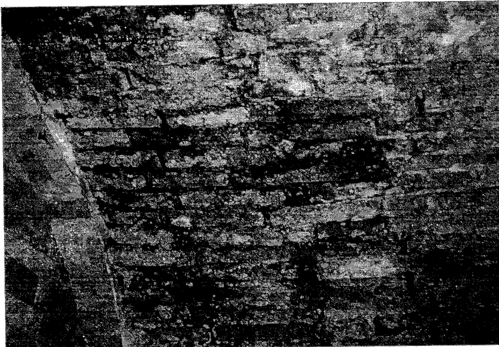
Soffitto ingresso (tracce umidità)
