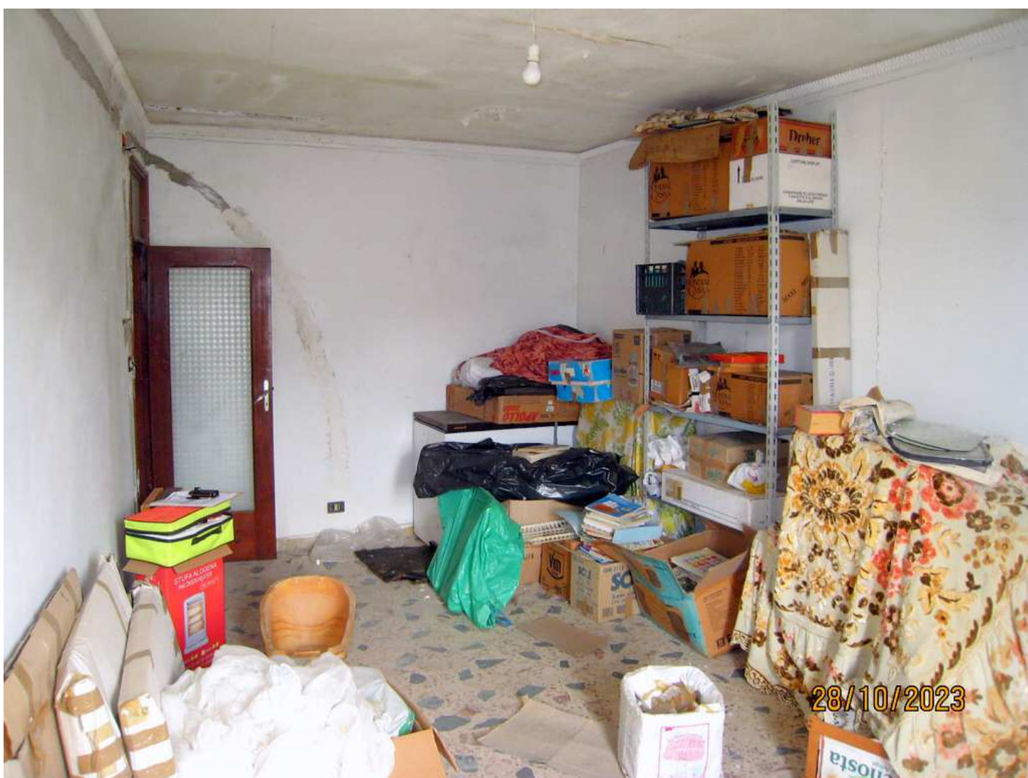
Foto n. 25. Le condizioni del tetto non sono buone a causa di infiltrazioni d'acqua dal tetto.
