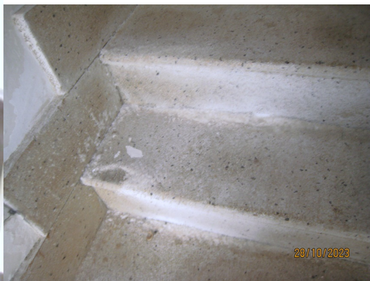
Foto n. 14. Dettaglio dell'umidità di risalita anche nella scala.
