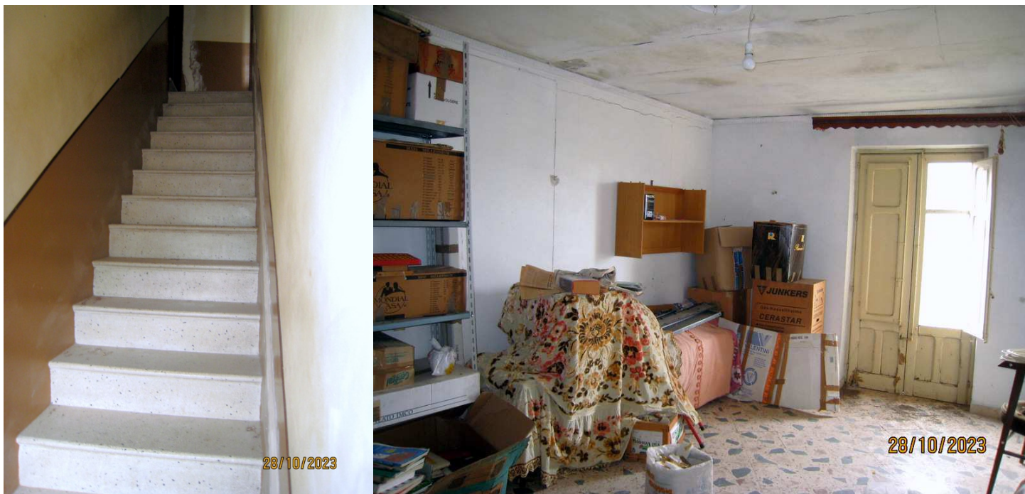
Foto n. 22. La rampa che porta al 2° piano. Foto n. 23. La stanza sopra il soggiorno, quella che ha il balcone crollato.
