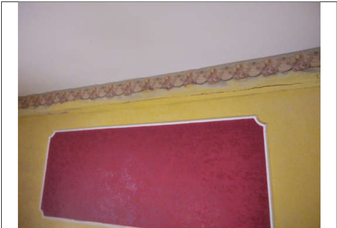
Foto n° 22. – Particolare difetto trave soggiorno
