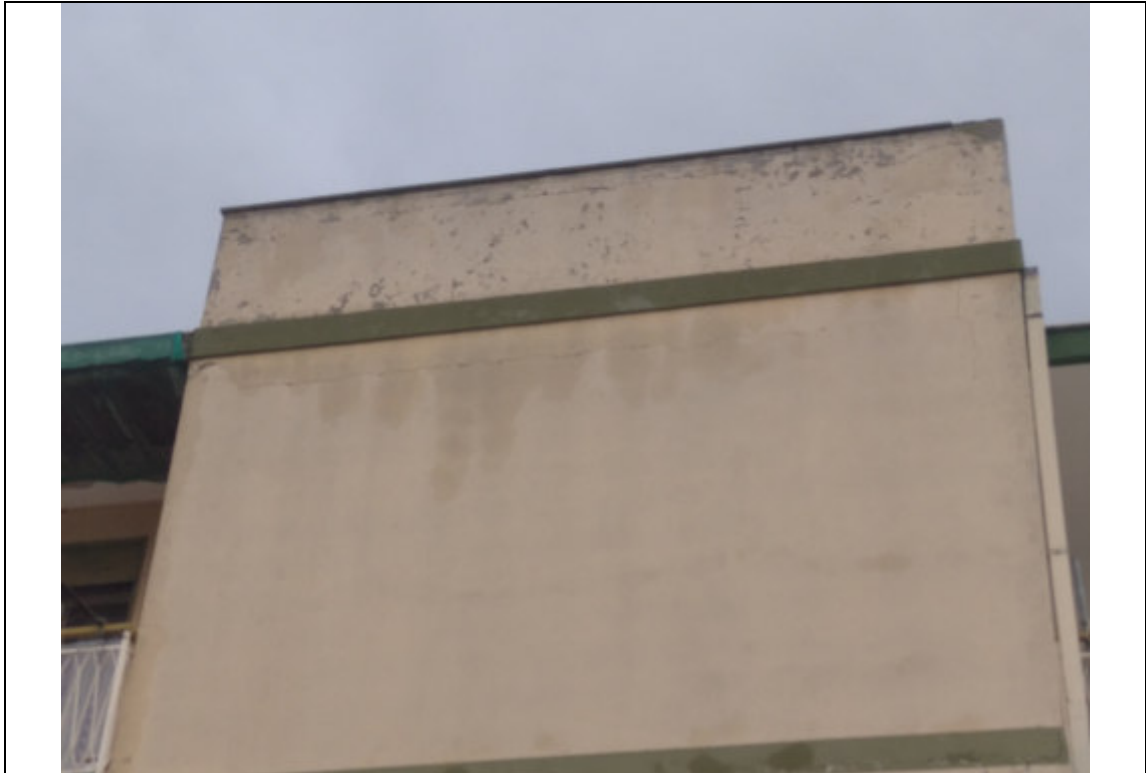
Foto n° 21. – Particolare difetto trave facciata
