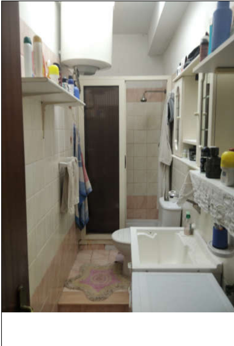
Foto n° 17. – Diffornità - WC - Lavandria
