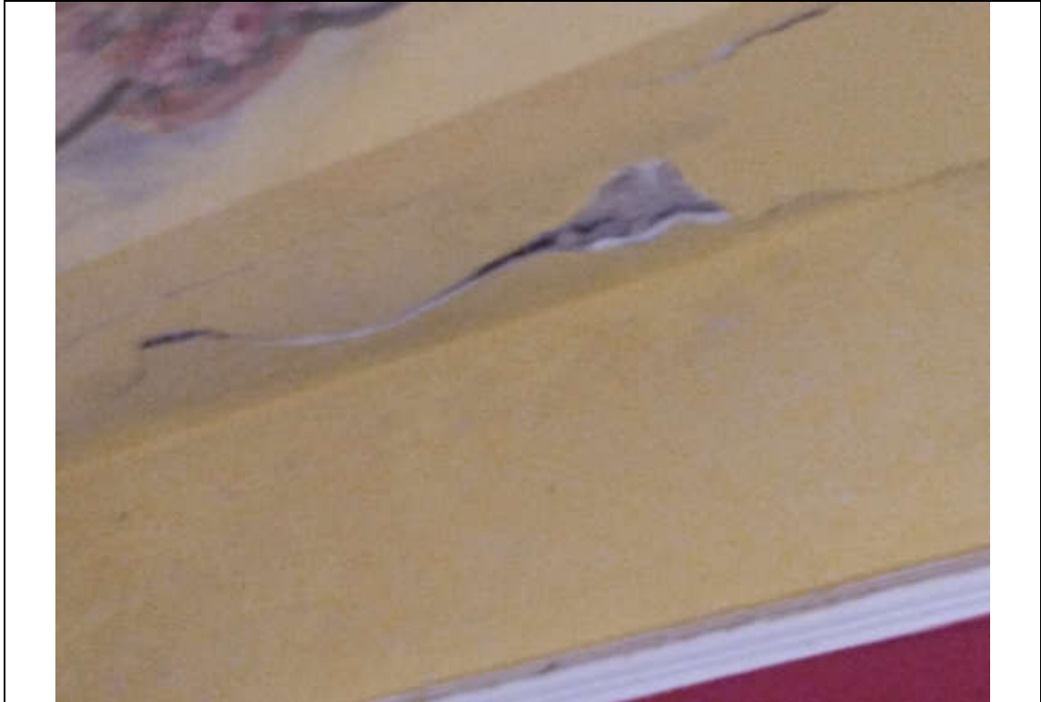
Foto n° 23. – Particolare difetto trave soggiorno
