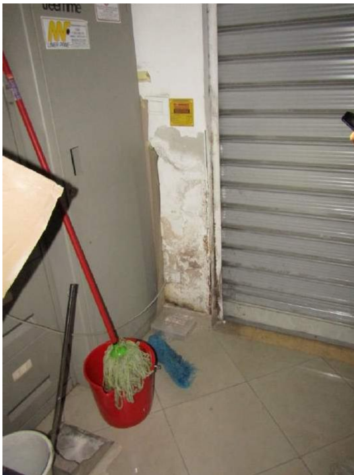
Foto 1.17 - LOTTO 1 - LABORATORIO ARTIGIANALE IN FOGGIA - PRIMO PIANO INTERRATO - UMIDITÀ DI RISALITA
