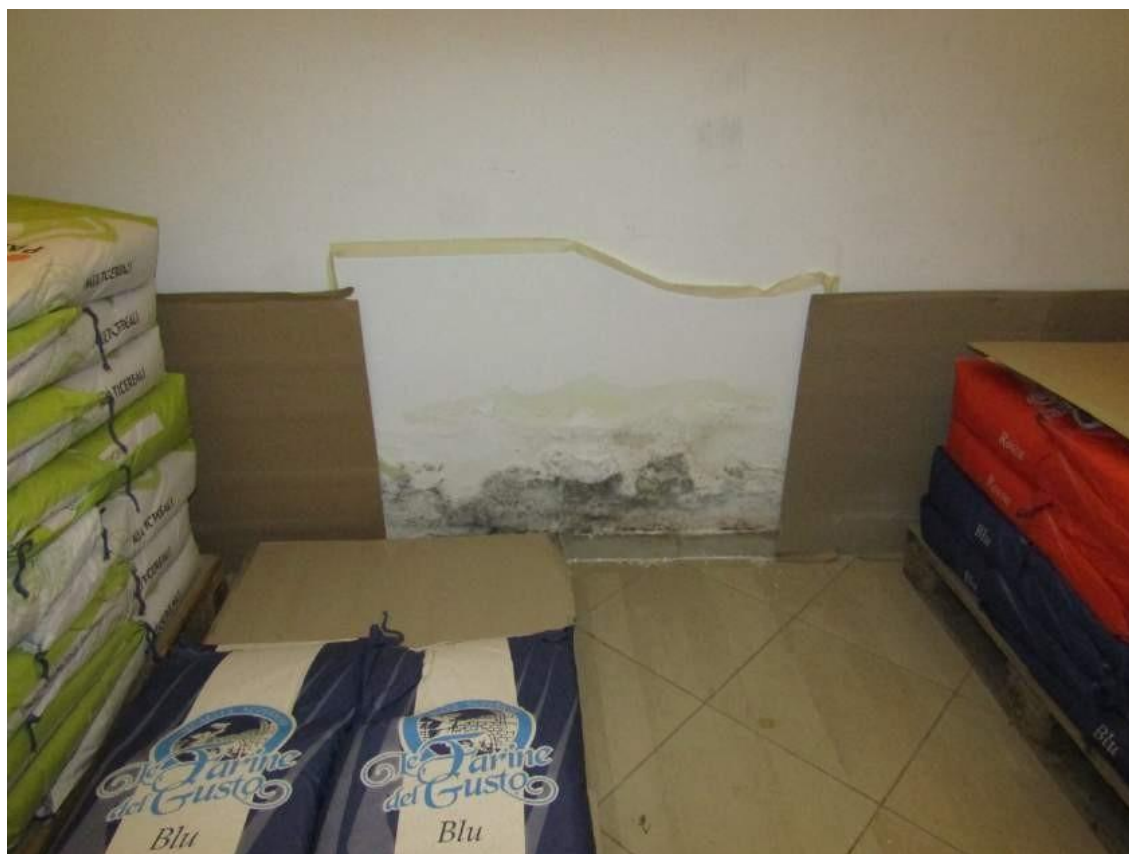
Foto 1.16 - LOTTO 1 - LABORATORIO ARTIGIANALE IN FOGGIA - PRIMO PIANO INTERRATO - UMIDITÀ DI RISALITA
