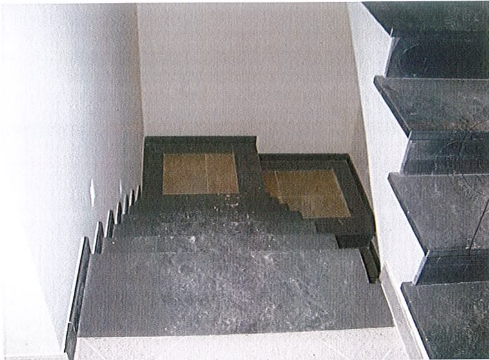
Foto n.7-19/3014 Vano scala con rivestimento in ardesia privo di ringhiera.
