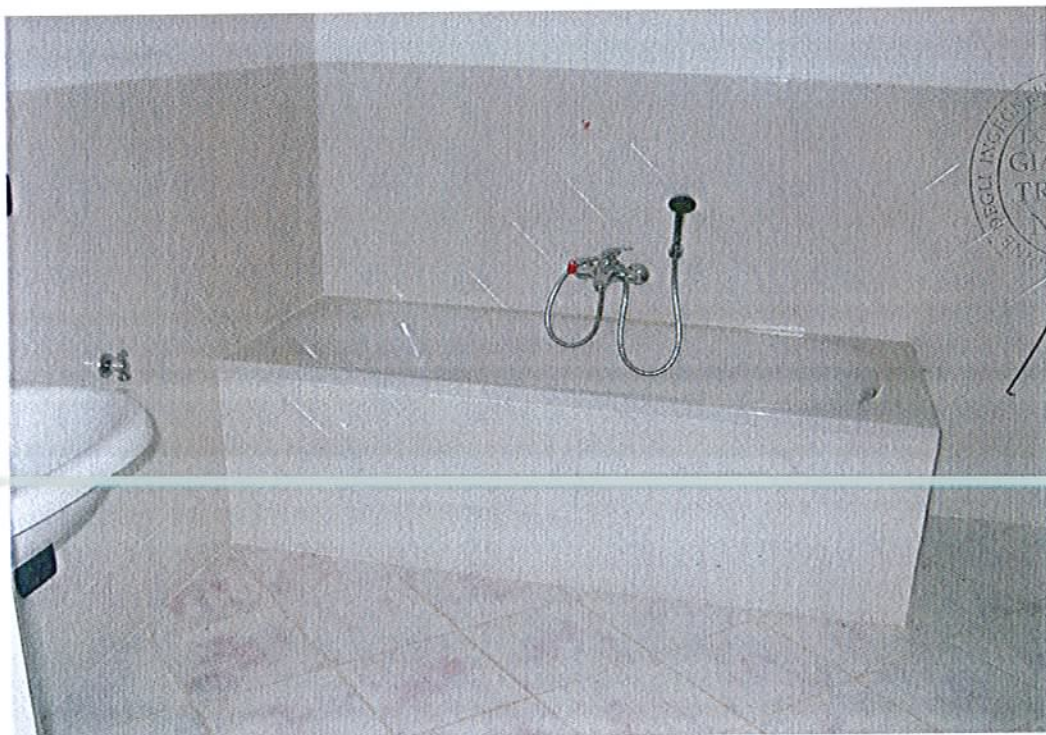
Foto n.6-15/1573 Servizio con vasca
