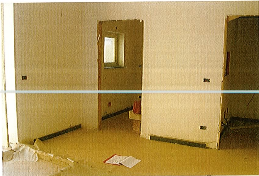
Foto n. 10-20/1897 Soggiorno privo di infisso.
