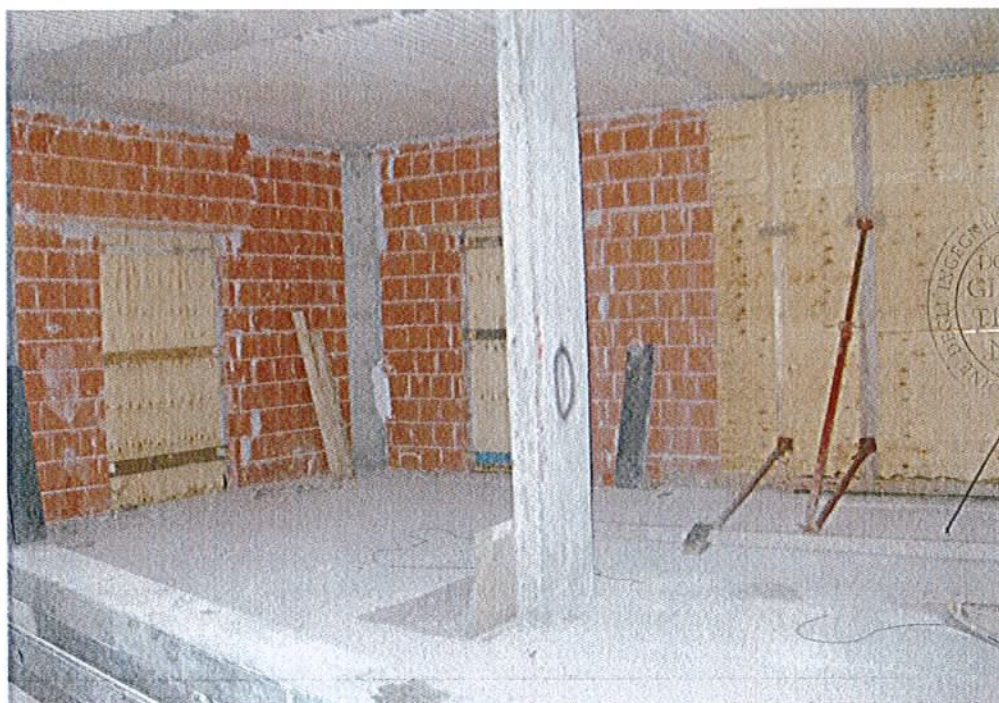
Foto n.3-33/3031 Stato delle opere interne nel locale
