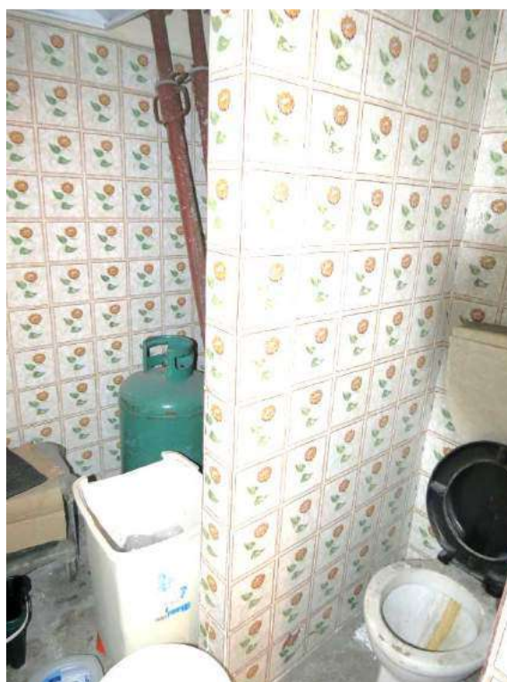
Foto n. 5: piano terra: locale wc
