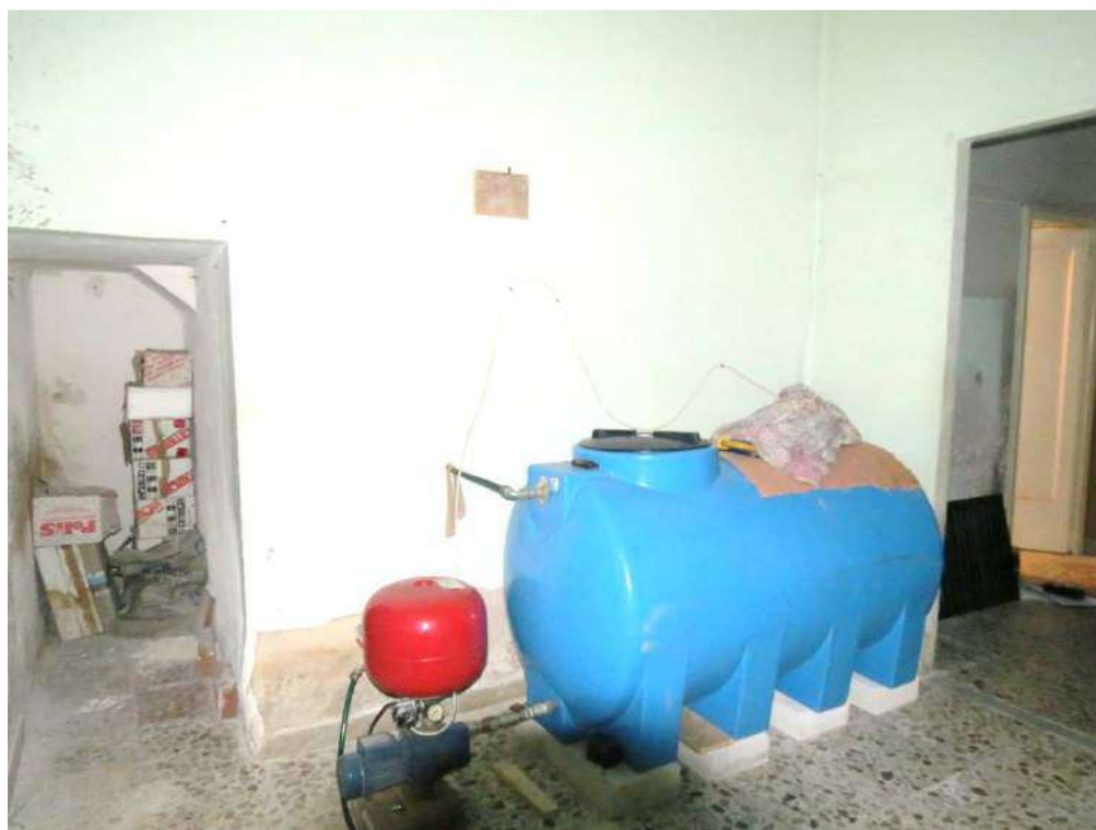
Foto n. 7: piano terra: locale vasche
