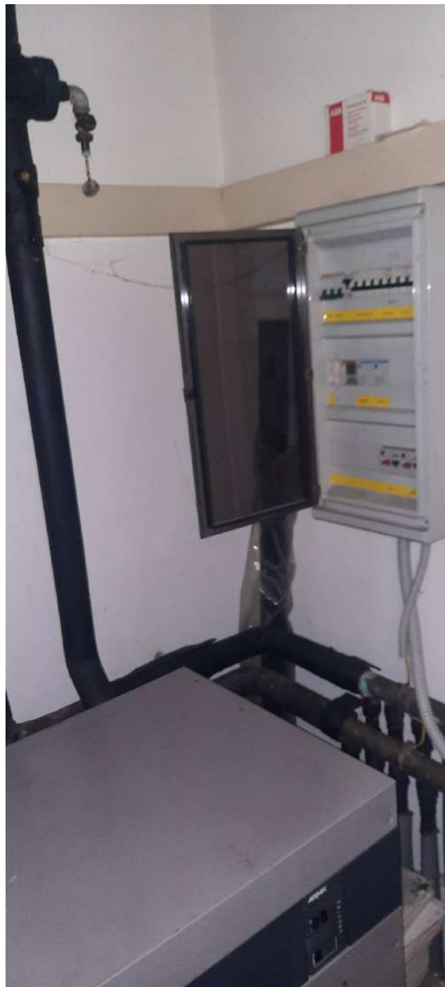
Quadro elettrico di comando generatore
