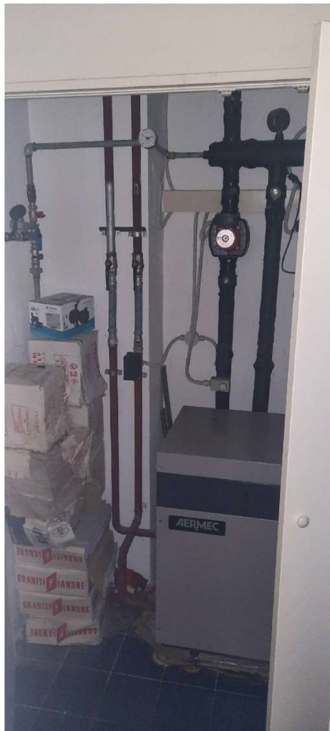
generatore a gas per il riscaldamento
