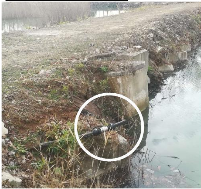
La tubazione di adduzione dell'acqua
