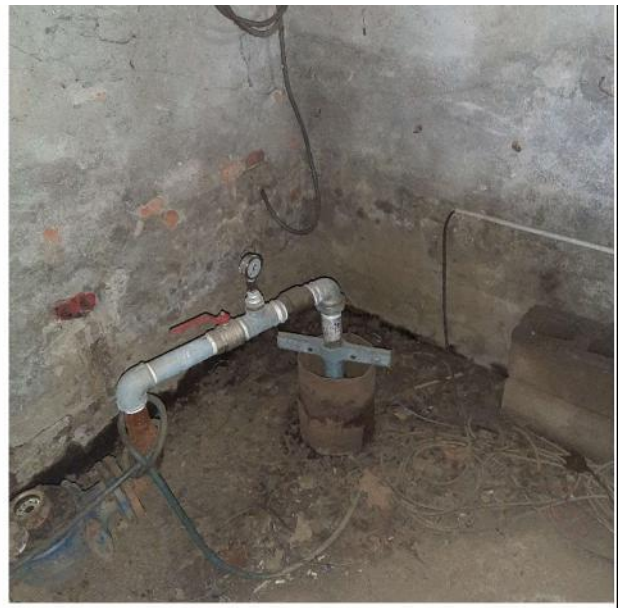
L'interno del manufatto con il pozzo di emungimento
