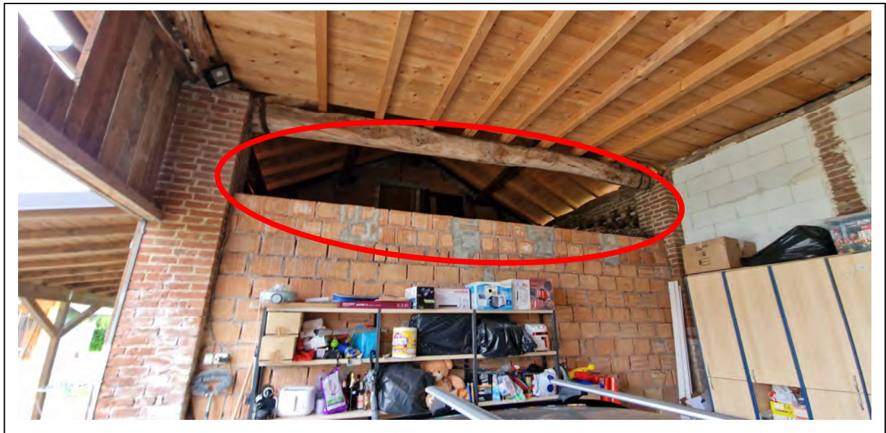
Piano Terra. Vista dal portico. Parete del soggiorno. È visibile il vuoto sul portico e l'assenza del solaio strutturale sopra al soggiorno.
