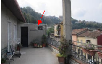
Foto 4 Terrazzo Abitazione foglio 58 p.la 1773 sub8 la freccia ripostiglio non assentito
