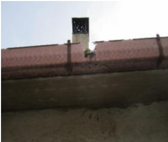
Foto 6-7 canali di gronda e pluviali dell'abitazione da sostituire
