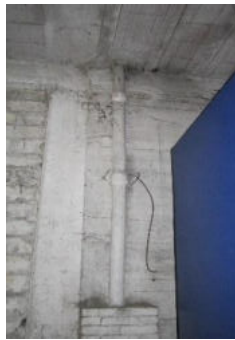
Foto 17 Interni Tubazioni di scarico in amianto da rimuovere . Infiltrazioni presenti.
