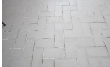
Foto 5 Terrazzo Abitazione foglio 58 p.la 1773 sub8 pavimentazione e impermeabilizzazione da rifare
