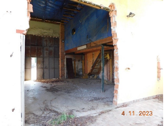
figura - vista corpo di fabbrica ex tettoia e porzione soppalcata realizzata in assenza di titolo edilizio
