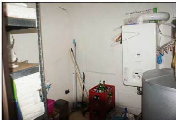
Depositi/ centrale termica
