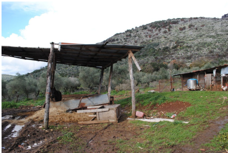
Figura 7. Una delle tettoie in precarie condizioni
