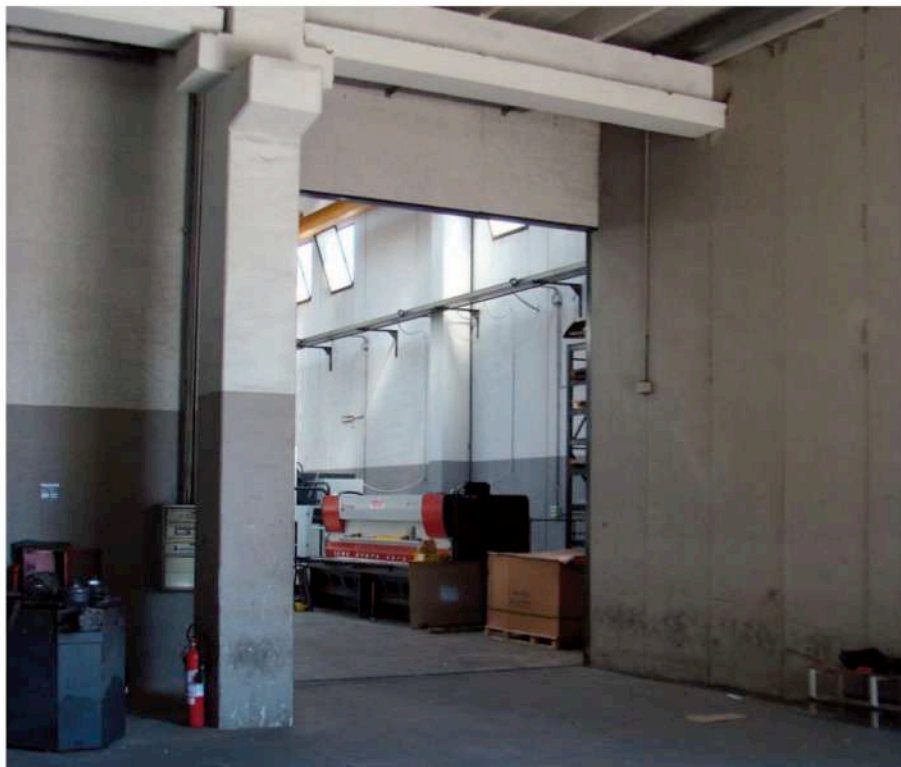
piano terra - collegamento altro SUB (lato EST)
