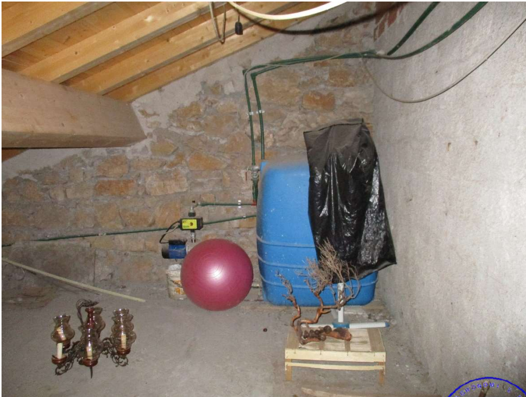
Foto 13 – Vista della Soffitta 2 con impianto idrico
