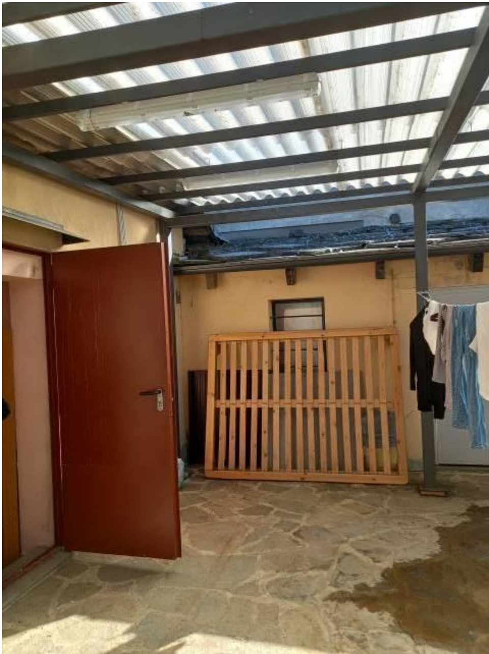
Fotografia n. 20 – Particolare del terrazzo
