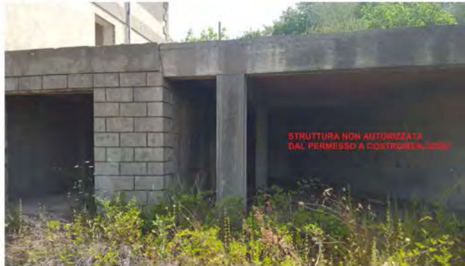
Fig. 42. Rappresentazione fotografica del corpo non autorizzato in aggiunta a quello principale.
