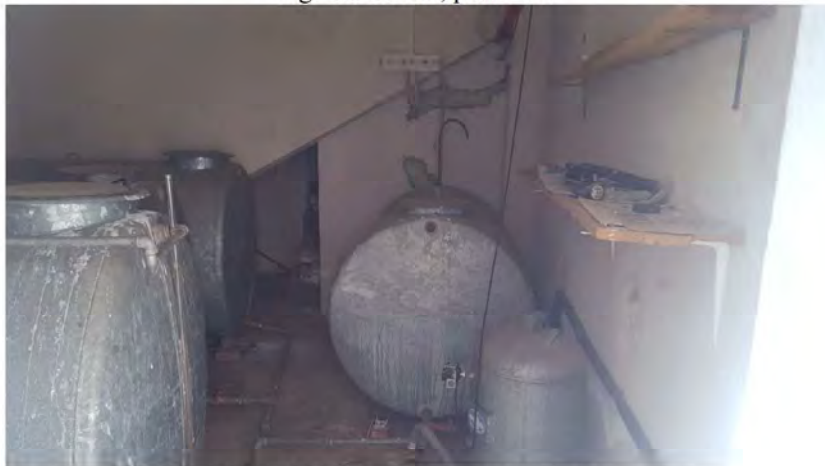
Fig. 24. Locale autoclave, piano S1.
