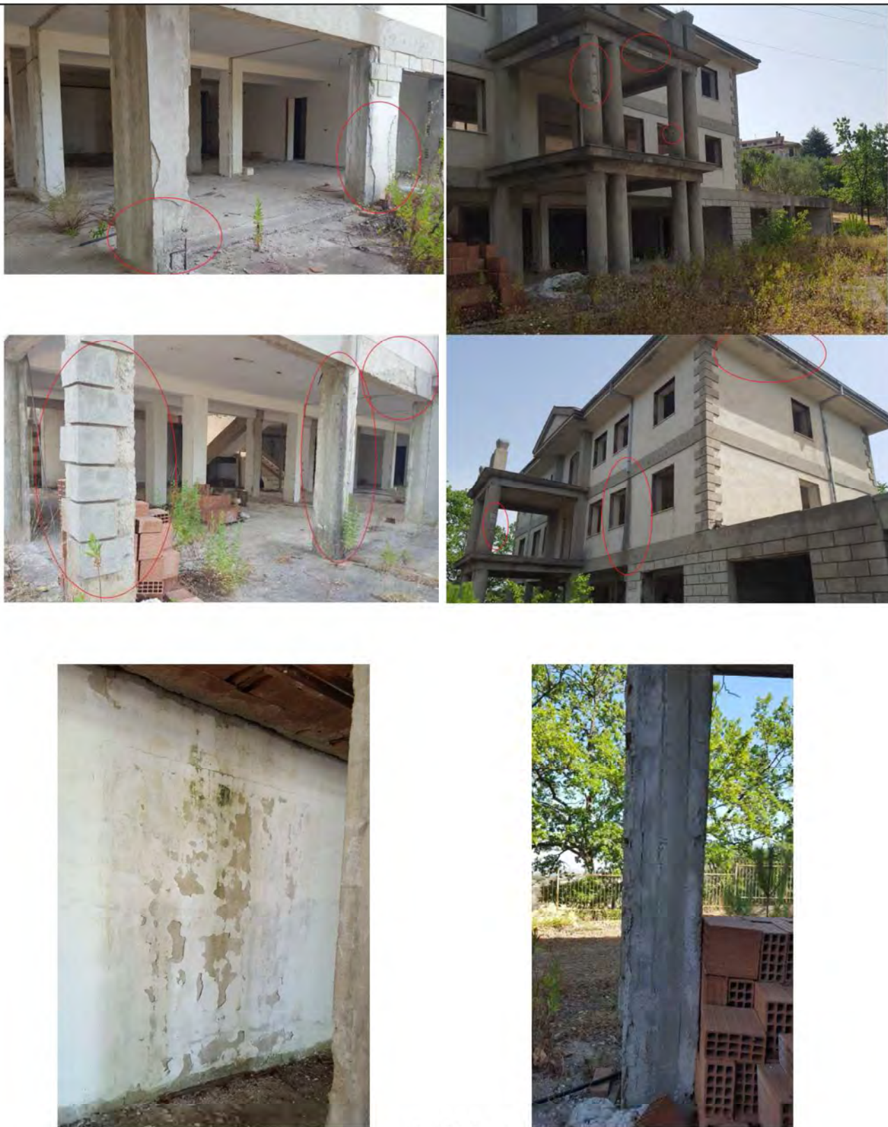
Fig. 39. Immagini rappresentative del deterioramento della struttura.
