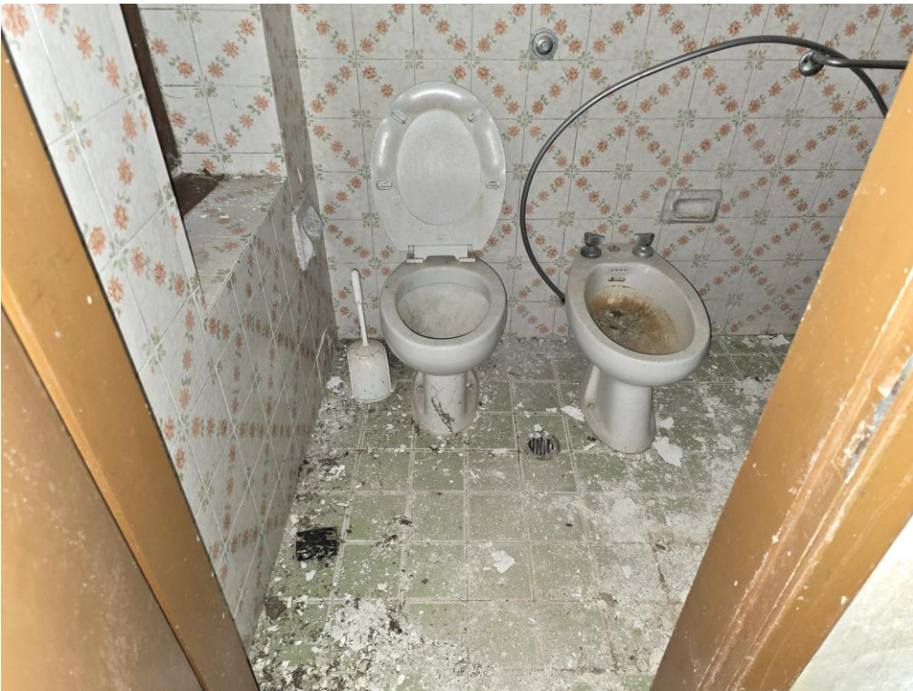
Bagno al piano primo
