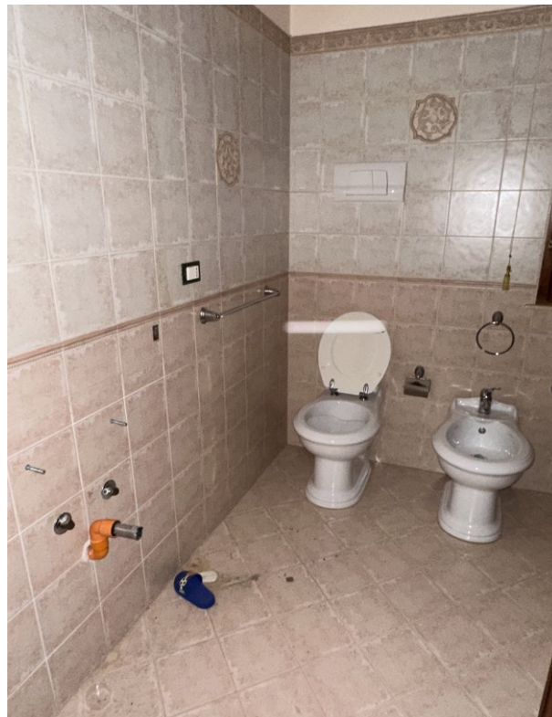
Foto n. 16 ; 17 ; 18 -Vista dell'ambiente bagno in cui è assente il lavandino
