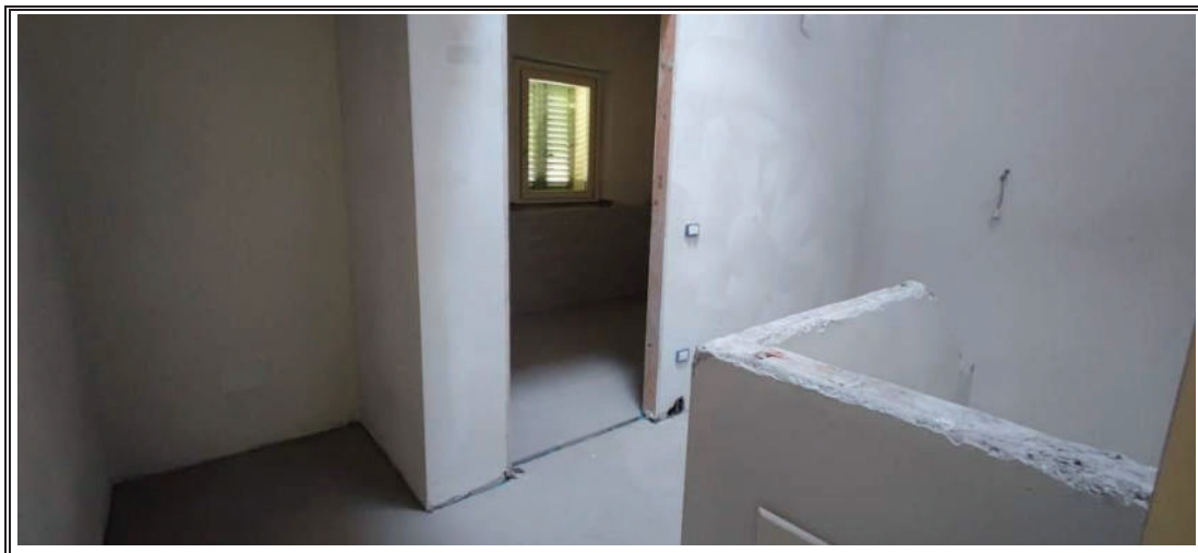
Foto n. 13– Appartamento mapp. 1580 sub 2 – Vano scale Piano primo
