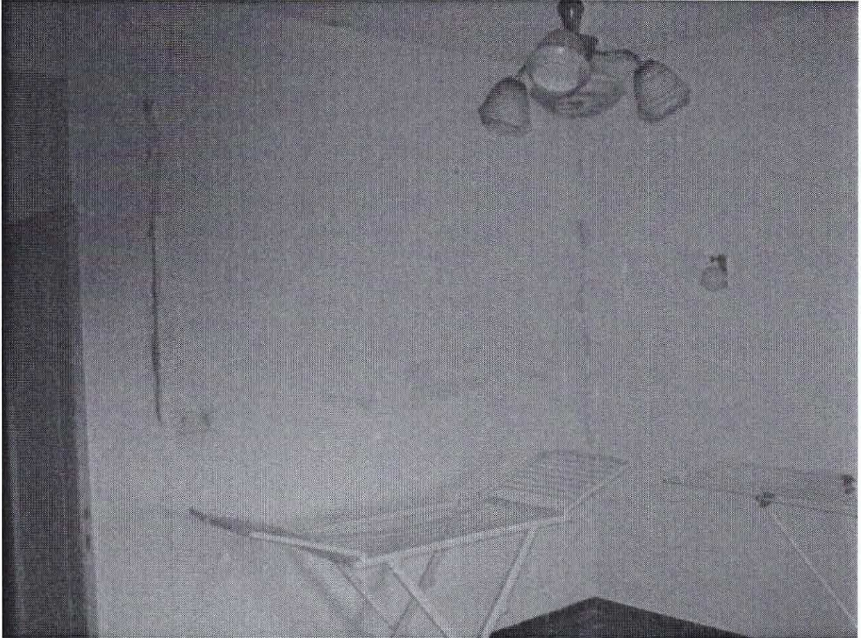
FOTO 3 – Particolare lesioni camera 1
