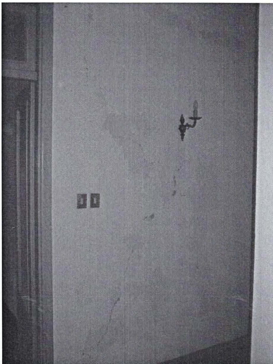
FOTO 1 - Particolare lezioni disimpegno appartamento
