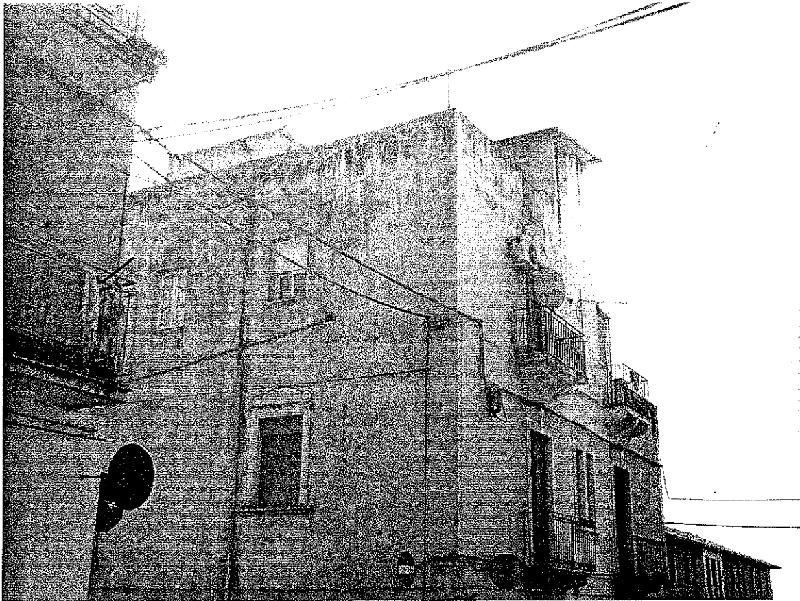
FO-23-PARTICOLARE DELLA FACCIATA NORD-OVEST IN CUI SONO EVIDENTI INFILTRAZIONI D'ACQUA
