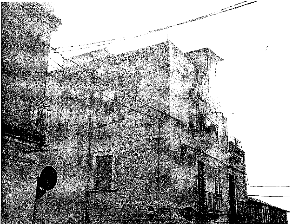
FO-23-PARTICOLARE DELLA FACCIATA NORD-OVEST IN CUI SONO EVIDENTI INFILTRAZIONI D'ACQUA
