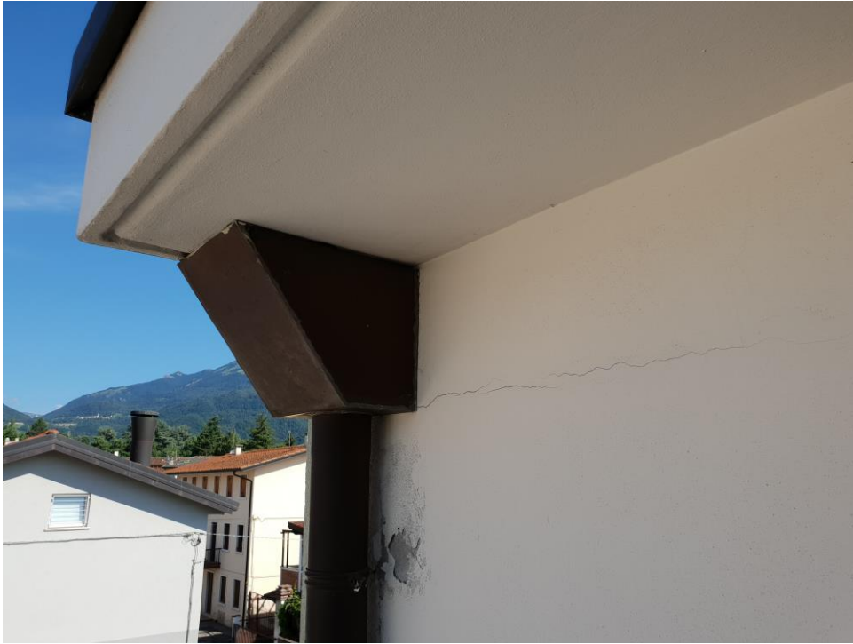
Foto n° 31 – particolare scrostamento intonaco
