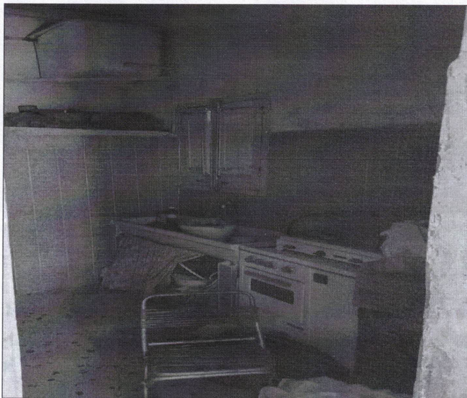
Foto 4: Particolare vano cucina - fabbricato via Marsala n.392 – C.da Rilievo - Trapani
