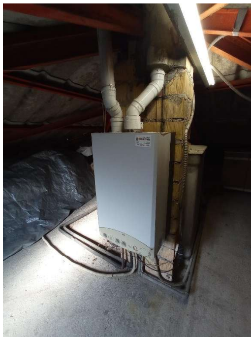
Vista sottotetto – Caldaia Piano Primo
