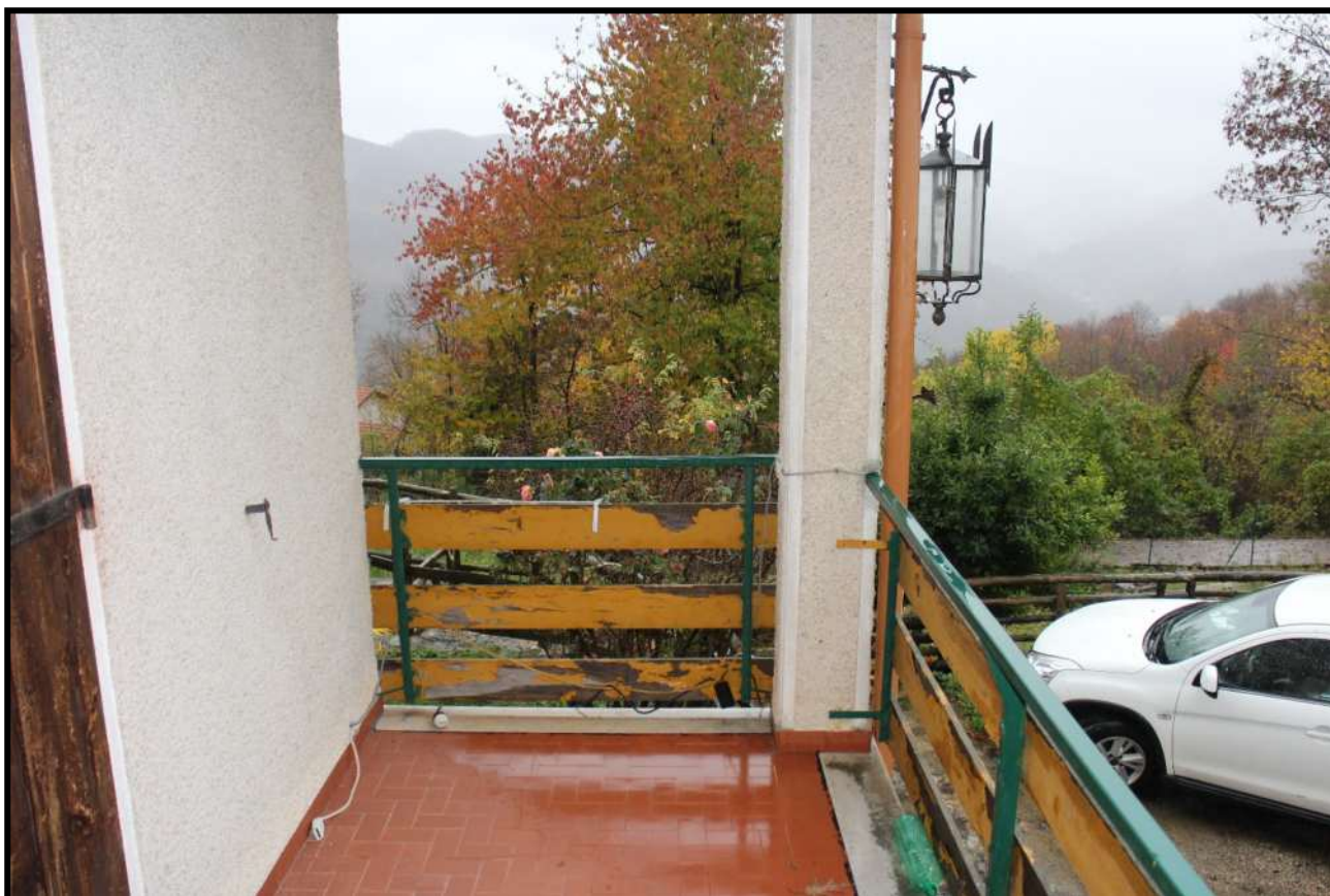
Foto 11 – Particolare balcone appartamento Corpo A
