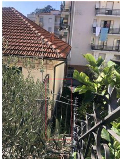
porzione di corte costituente copertura dell'intercapedine dei box interrati - vista da monte
