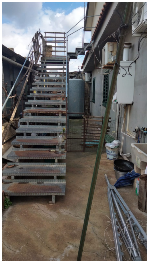
Scala in ferro accesso al piano 1°
