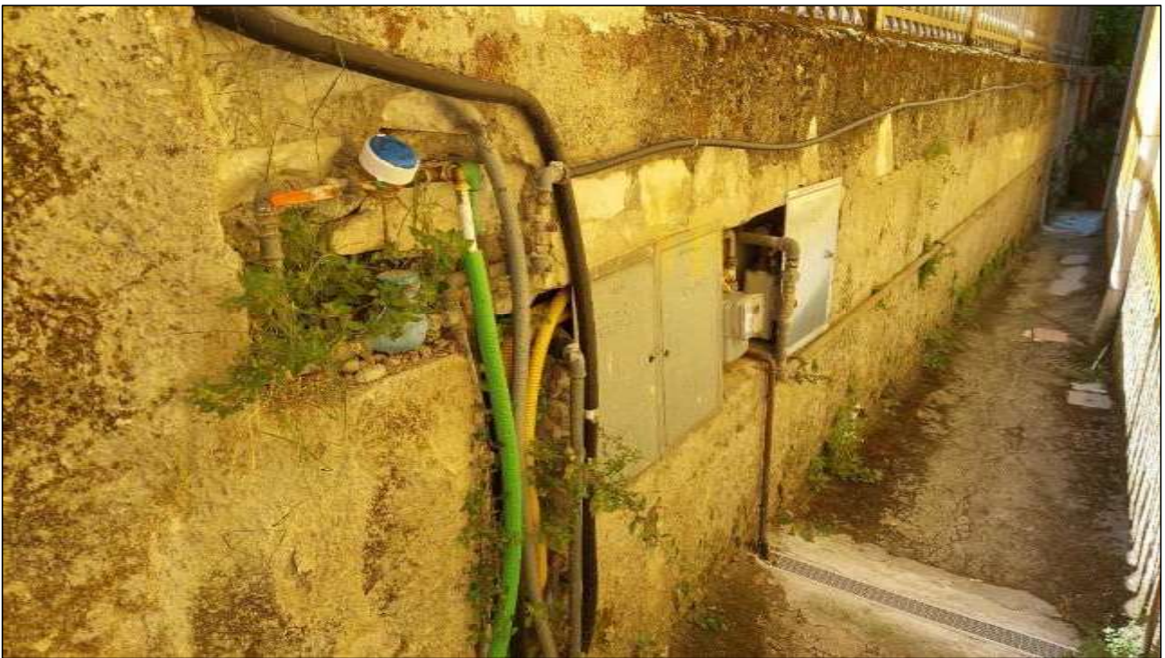
FOTO 19 – corte comune – part. Contatori posti lungo muro di recinzione perimetrale
