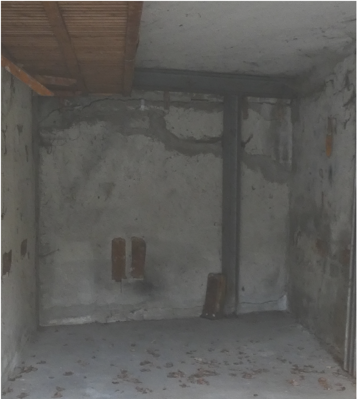
24-alcune fessurazioni all' interno box di*****Omissis*****.
