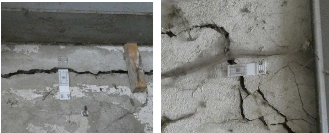
27-dettaglio di alcuni “vetrini per crepe/fessurimetri” all’ interno box di ****Omissis****.
