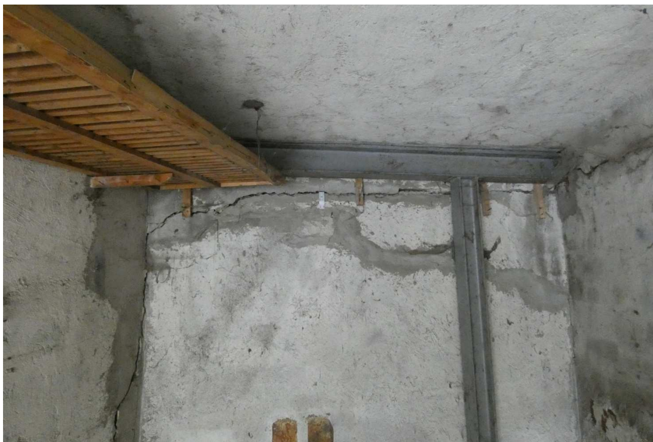
26-dettaglio di alcune fessurazioni e della struttura in metallo all' interno box di *****Omissis*****.
