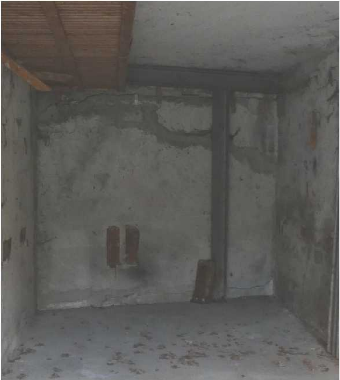
21-alcune fessurazioni all' interno box di****Omissis****.
