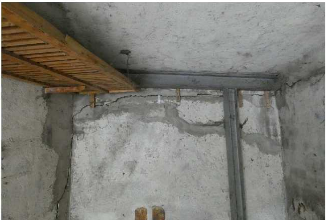
23-dettaglio di alcune fessurazioni e della struttura in metallo all' interno box di ****Omissis****.
