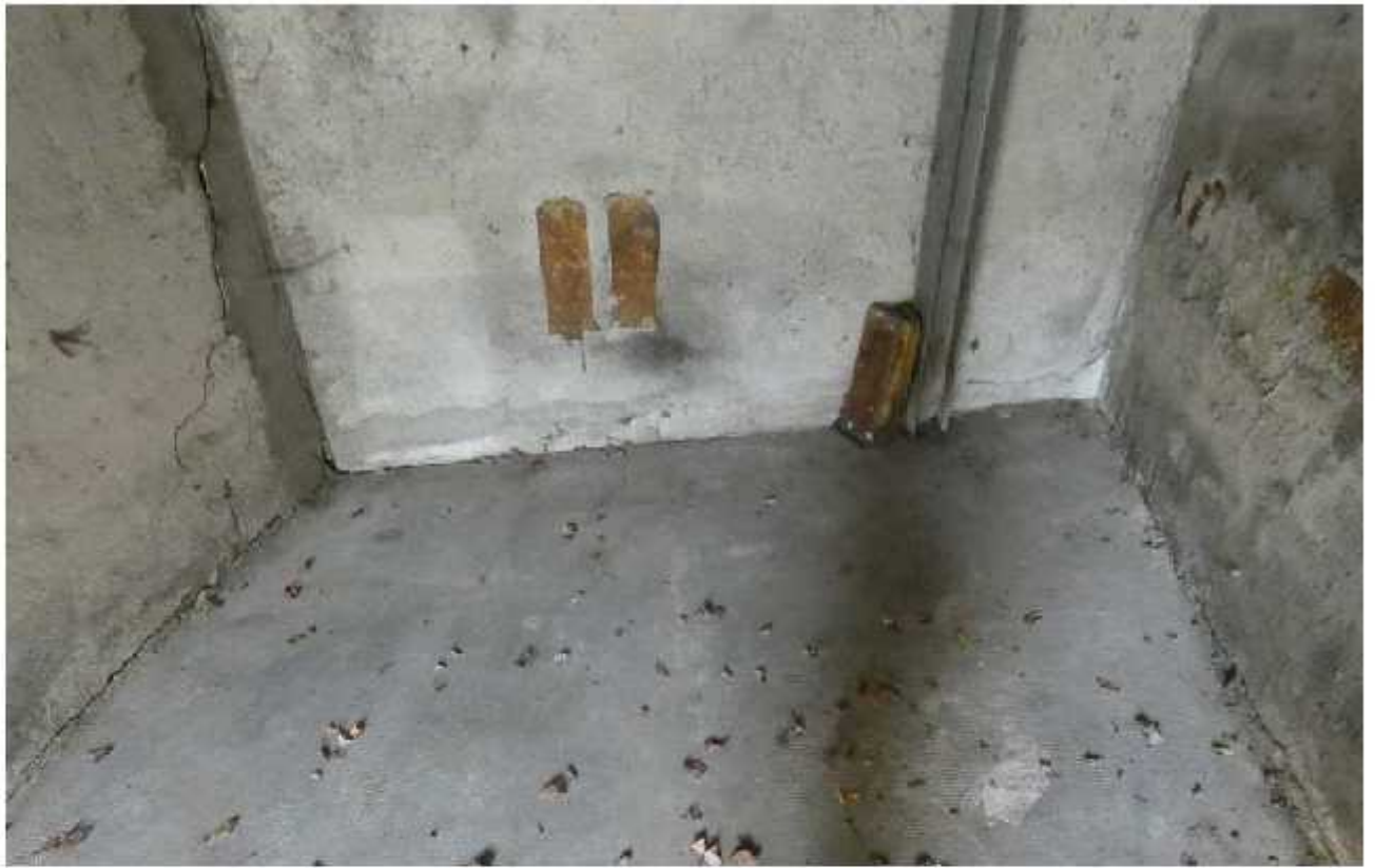
22-dettaglio di alcune fessurazioni e della struttura in metallo all' interno box di ****Omissis****.
