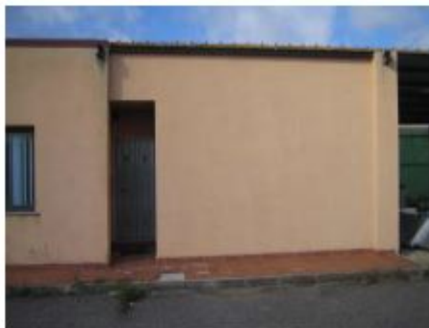
Foto 10, Locale tecnico ingresso
