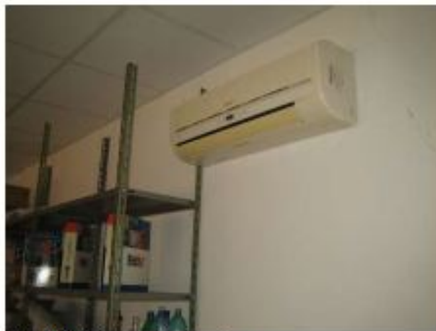
Foto 8, Unità interna climatizzazione
