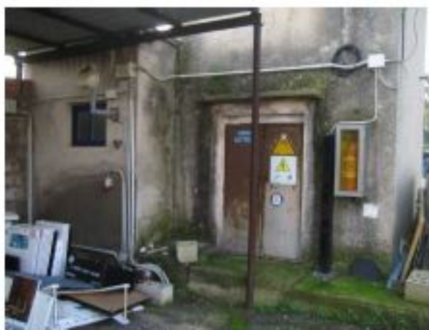
Foto 4, Vista esterna Cabina elettrica
