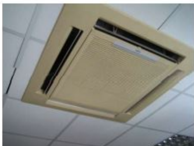
Foto 11, Unità di riscaldamento e raffreddamento a soffitto
