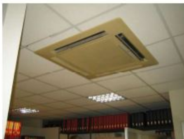
Foto 12, Unità di riscaldamento e raffreddamento a soffitto
