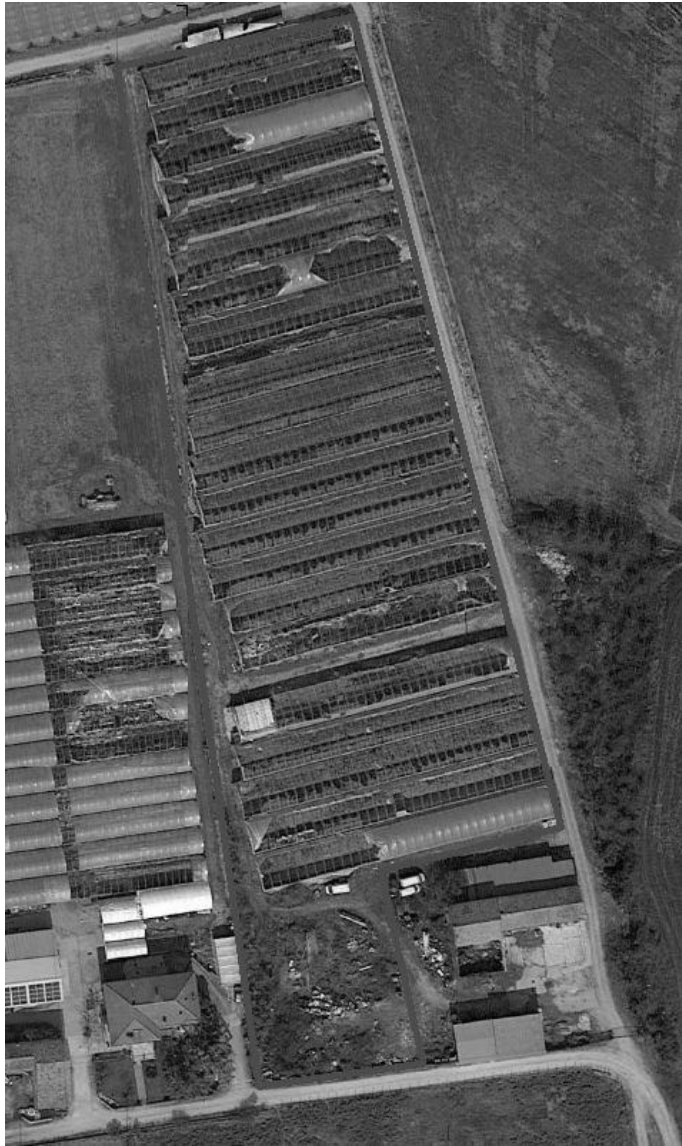
Vista satellitare del mapp. 89 CT fg. 40 Comune di Villafranca di Vr dove sono presenti serre a tunnel con coperture fortemente deteriorate e ripresa fotografica effettuata nel corso del sopralluogo
