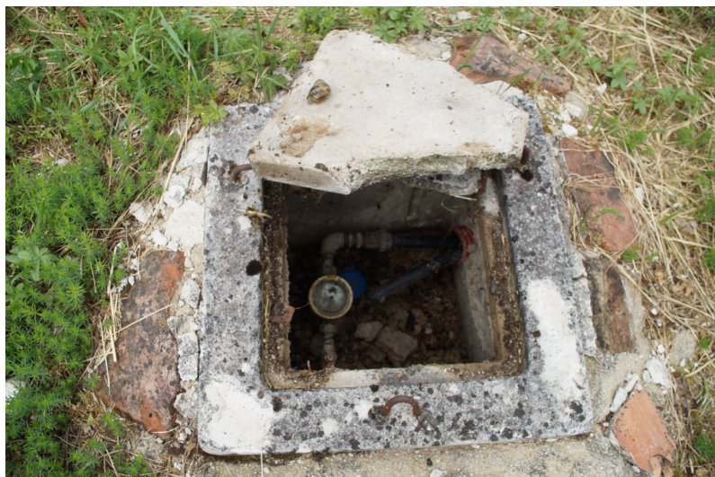
Foto n°15: altro particolare del contatore dell'acqua.
