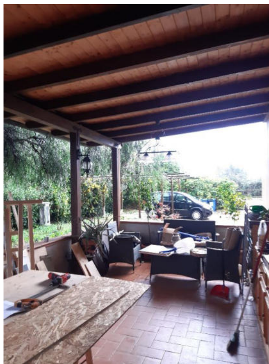
Foto esterna Abitazione – Tettoia abusiva (Bene n.1)
