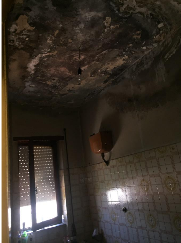
Soffitto vano Bagno piano primo
