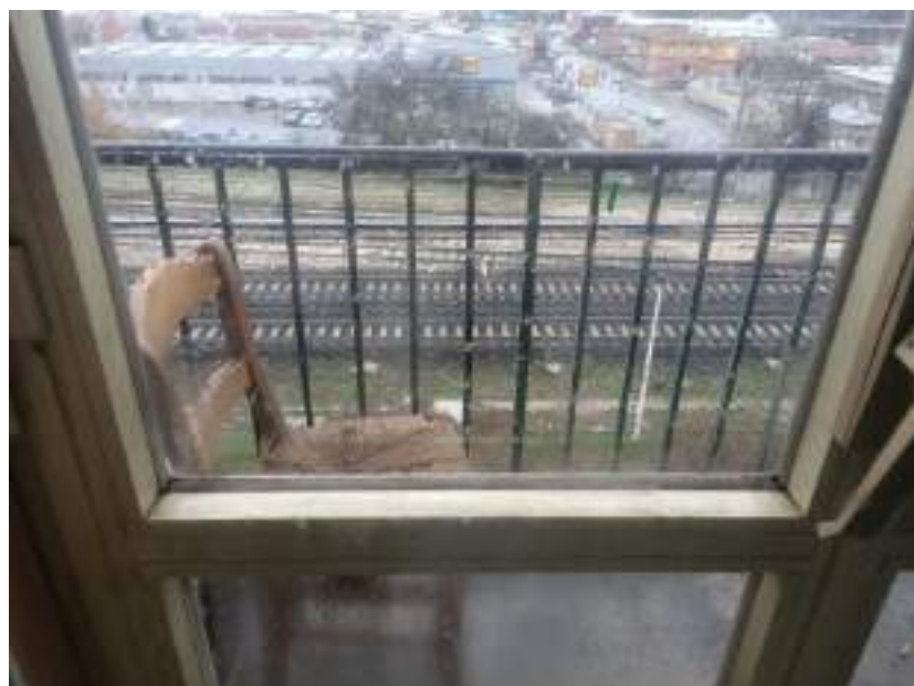
Particolare tipologia infissi in alluminio con doppie finestre in alluminio e vista ferrovia sul retro e balcone
