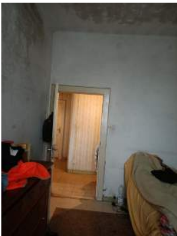
Vista camere con particolare mufte a pareti e soffitti
