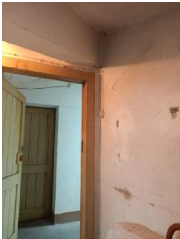
Viste soffitta di pertinenza esclusiva e particolare cisterna comune, presumibilmente in Eternit
