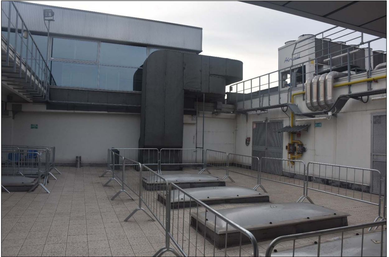
FOTO N. 11: Copertura -machine per il trattamento dell'aria
