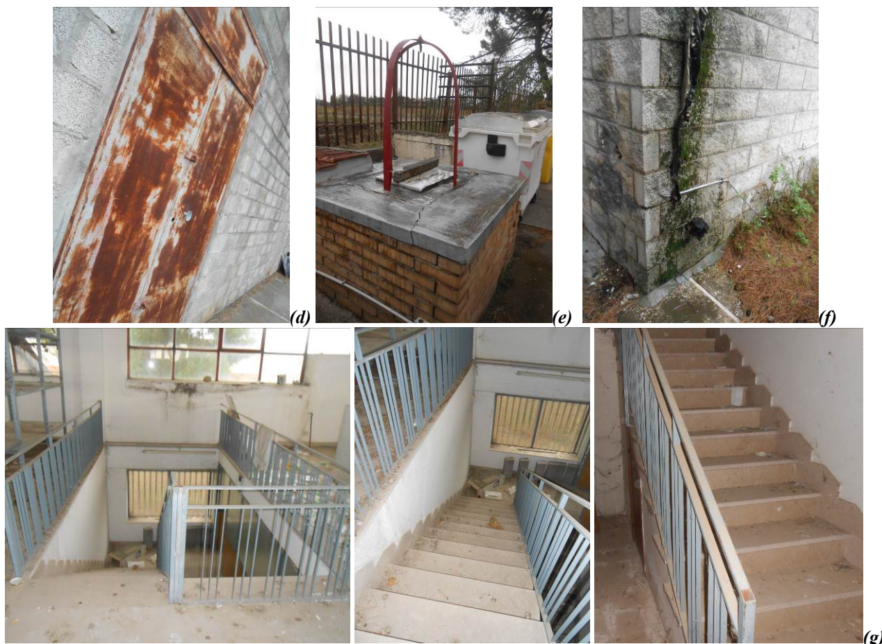
Figura n° 4. Fotografie del complesso edilizio adibito a laboratorio artigianale sito in via Luigi Cannelonga n° 17 – Zona PIP: cancelli di accesso e recinzione (a); facciate del capannone (b); piazzale in cemento e area esterna a giardino (c); rampa di salita, portone di accesso al P1 e portone del deposito esterno (d) pozzo (e); discendente pluviale danneggiato (f); scala interna (g).
