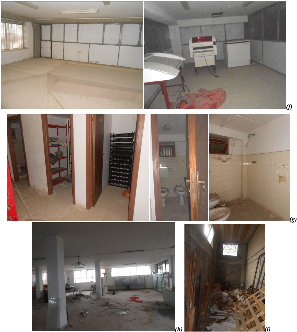
Figura n° 7. Fotografie del capannone ad uso artigianale: officina di falegnameria (a); ingresso a pianterreno (b); ufficio/esposizione (c); area di verniciatura con annesso deposito (d); bagnetto a pianterreno (e); locali di sgombero in piano intermedio soppalco (f); bagni e ripostigli a pianterreno a servizio del primo piano (g); laboratorio a primo piano (h); deposito esterno sotto-rampa (i).
